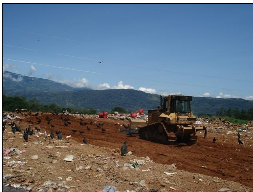
Fig 2. Maquinaria en la celda.
