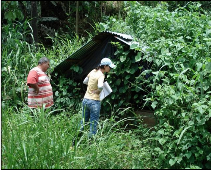
Fig 5. Pileta rústica de lixiviados sin uso y en mal estado.
