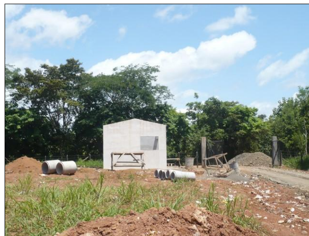
Fig 4. Caseta de entrada incompleta
