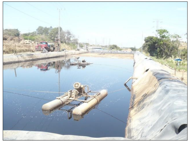
Fig 2. Planta de tratamiento.
