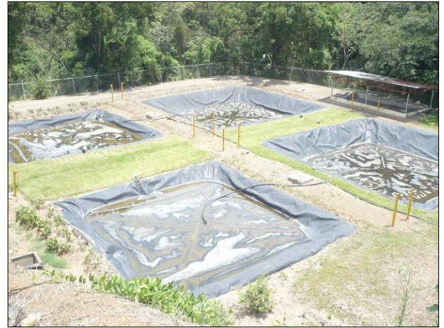
Fig 8. Planta de tratamiento.
