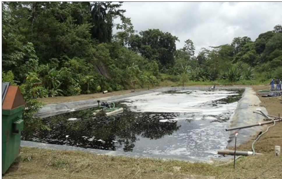
Fig 5. Laguna de pretratamiento de lixiviados.
